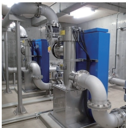
浄水用紫外線照射装置 (内部照射型縦置き)
