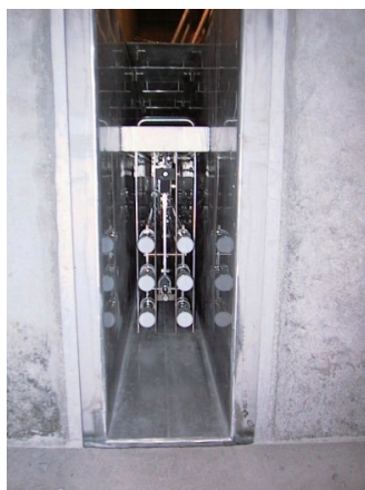
下水処理水の消毒装置 (開水路型)
