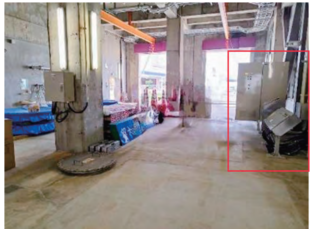
図13 紫外線装置電源盤建屋
