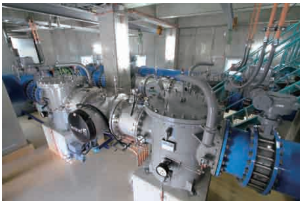
▲ 雄総水源地紫外線処理施設（設備全体）
