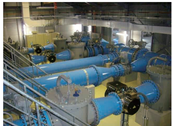
▲ 鏡岩水源地紫外線処理施設（設備全体）
